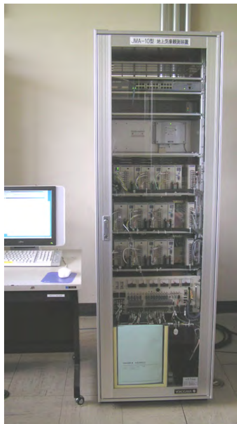
写真 12 屋内装置（外観）
