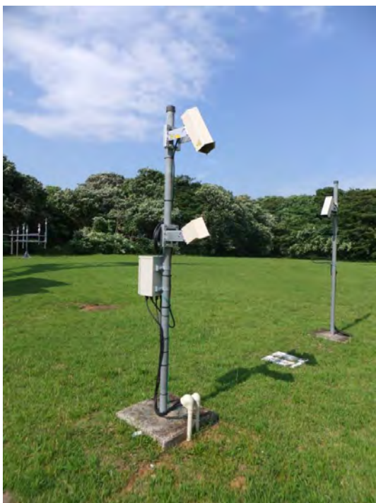
写真7 積雪計及び人体検知器 (外観)
